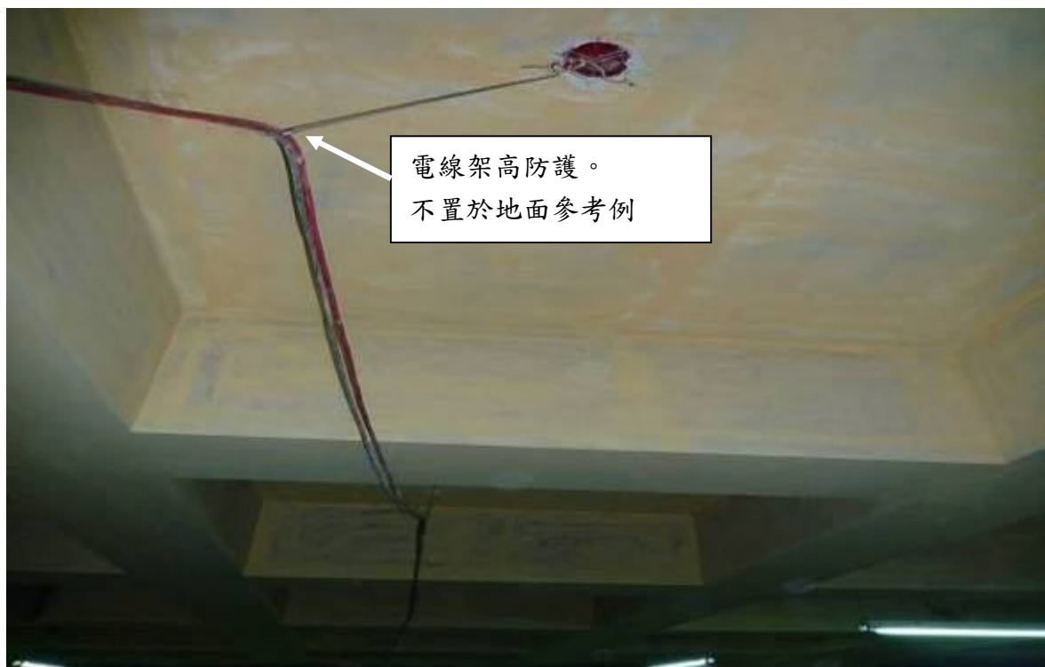
電線架高防護
